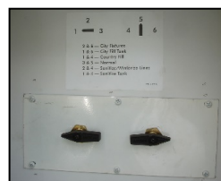
Fig. A - Contrôles des robinets d'eau
