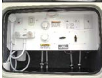
Fig.B - Utility Center
